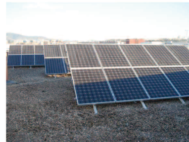
Panneaux solaires photovoltaïques
