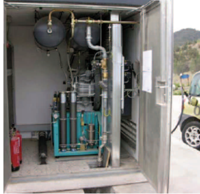
Equipo de compresión (izquierda) y estación de servicio (derecha)
