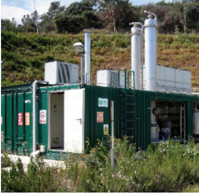
Planta de tratamiento de biogás
