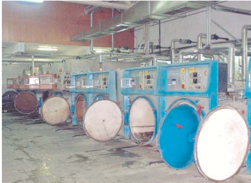
Batterie du pasteurisateurs
