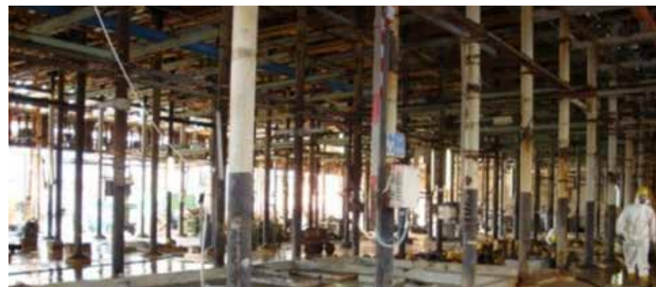
Plancher de la salle de cellule régulièrement arrosé
